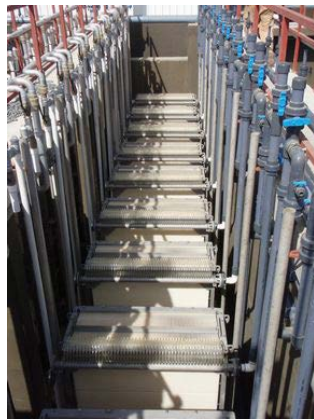
MBR設備の改良、改造 流束改善
